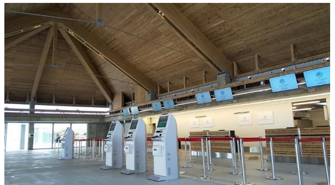
屋根構造材に CLT（直交集成版）を使用したチェックインロビー
